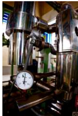
バイオマス発電施設
