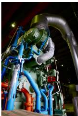
雨水ポンプ施設
