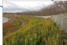
写真：雑草が生えた武庫川堤防
